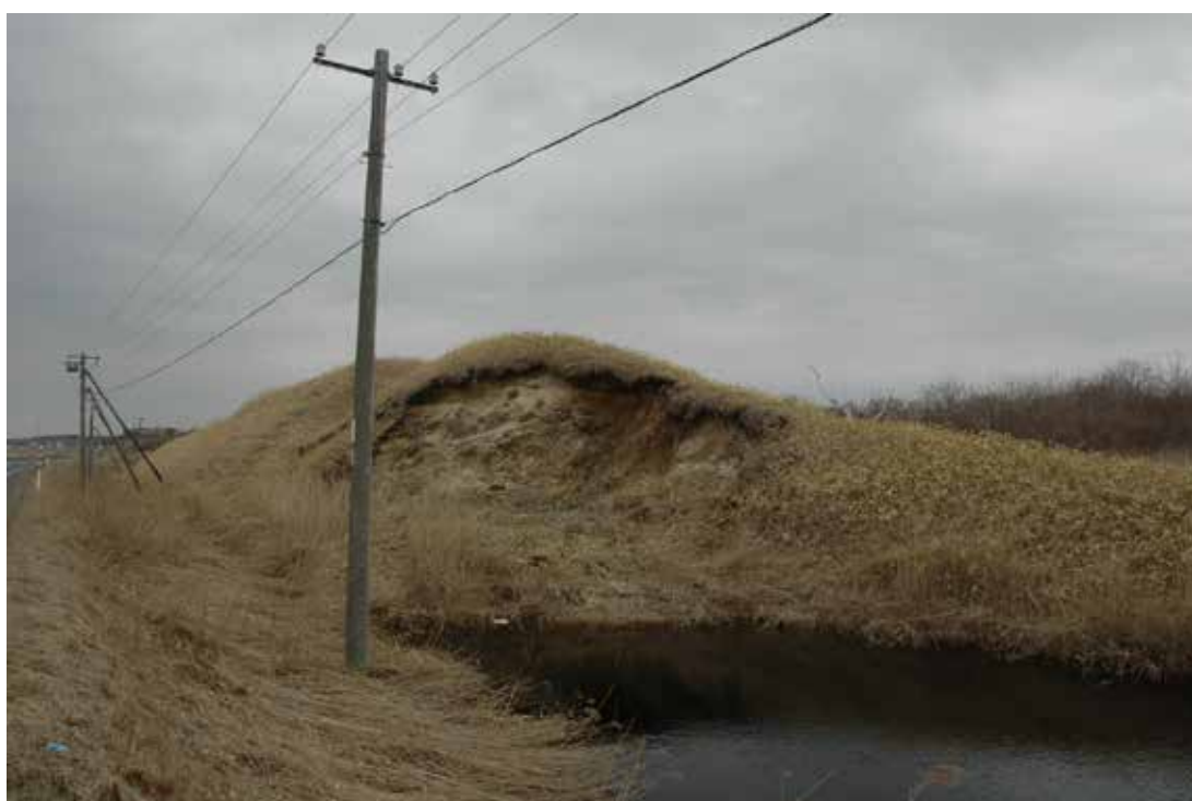
②床丹1 チャシ跡（崩壊状況-北側）
