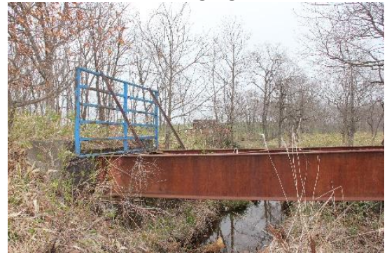
図3 床丹3の川に架かる旧標津線鉄橋 この鉄橋の西側(国道側)には弾痕がなく、東側に面する部分の下流側に3カ所(図
